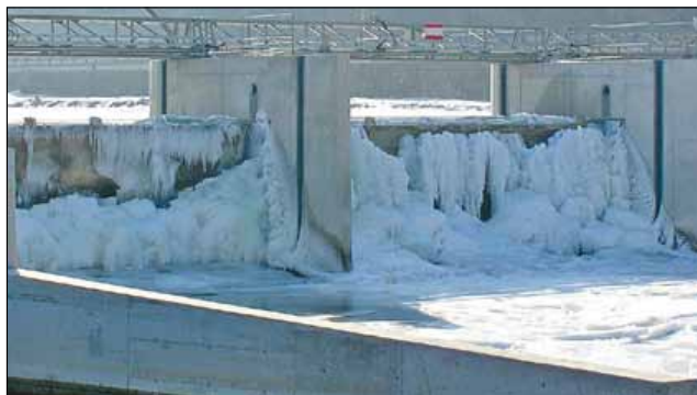
Zamrznutá Malá vodná elektrárň Hronská Dúbrava. Voda v malých vodných elektrárňach môže často zamrzáť a následne spôsobovať ľadové povodne, ktoré ohrozujú obyvateľov a ich domovy v okolí. Autor: Jaroslav Gazdík
